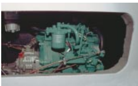
Der seitliche Zugang zum Motor ist etwas eng geraten.
